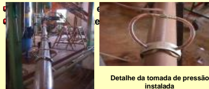
Tubulação de recalque instalada com as tomadas de pressão
